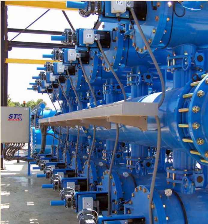
Estación de filtrado del bitrasvase del Besaya, en Reinosa, integrada en las infraestructuras de regulación y control del abastecimiento de agua. Fuente: ACUAES (Aguas de las Cuencas de España, SME).
